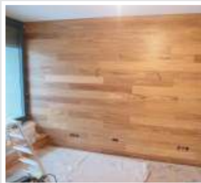
Stěna odhlučňena systémem W 40 s dřevěným obkladem.
