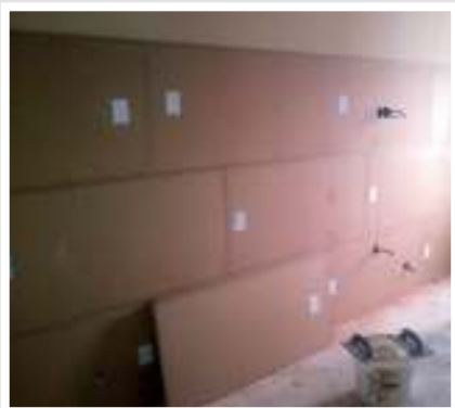
Montáž desek Wolf na masivní mezibytovou stěnu pomocí akustických hmoždinek, systém W 40.
